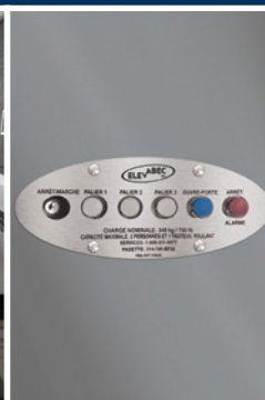
Station de commande dans la cabine
